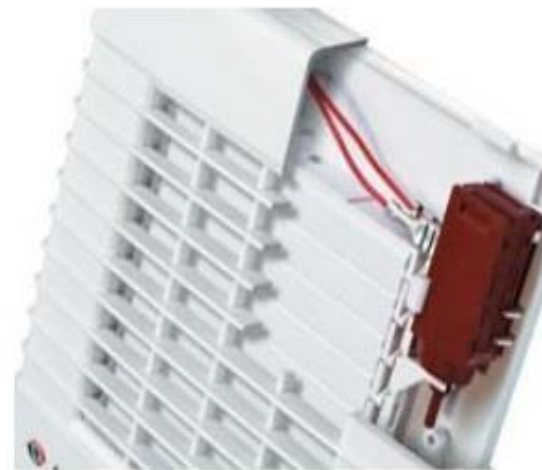
Ventilators nestrādā (žalūzijas ir ciet)
